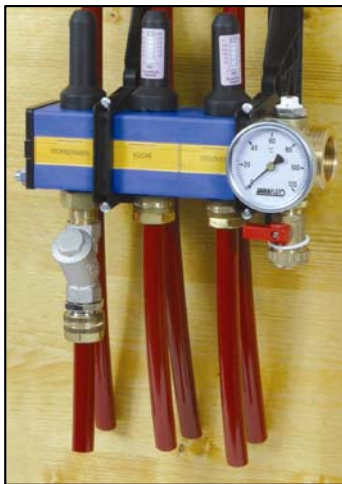
Montage sur le répartiteur de circuit de chauffage
