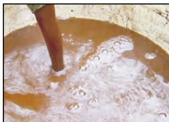
Eau de chauffage encrassée
